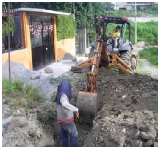
Construcción de red de distribución de agua potable, colonia Valle Dorado y Ampliación Tres de Mayo.
